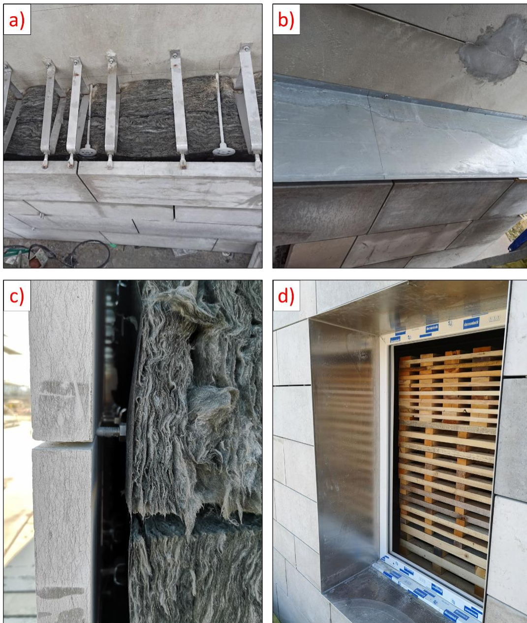
Figure 3 : Photos détaillées illustrant le principe constructif : a) système d'attaches entre les plaques en pierre naturelle et la façade support ; b) bavette de recouvrement en tôle d'acier galvanisé pliée (15/10 mm) ; c) constitution de la paroi dans son épaisseur : plaque de pierre calcaire, lame d'air et isolant; d) encadrement de fenêtre au RDC en tôle d'aluminium d'épaisseur 10/10 mm, laissant apparaître le bûcher de bois (600 kg)
